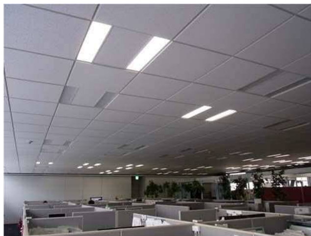
図2.2.14 LED照明の点灯状況
