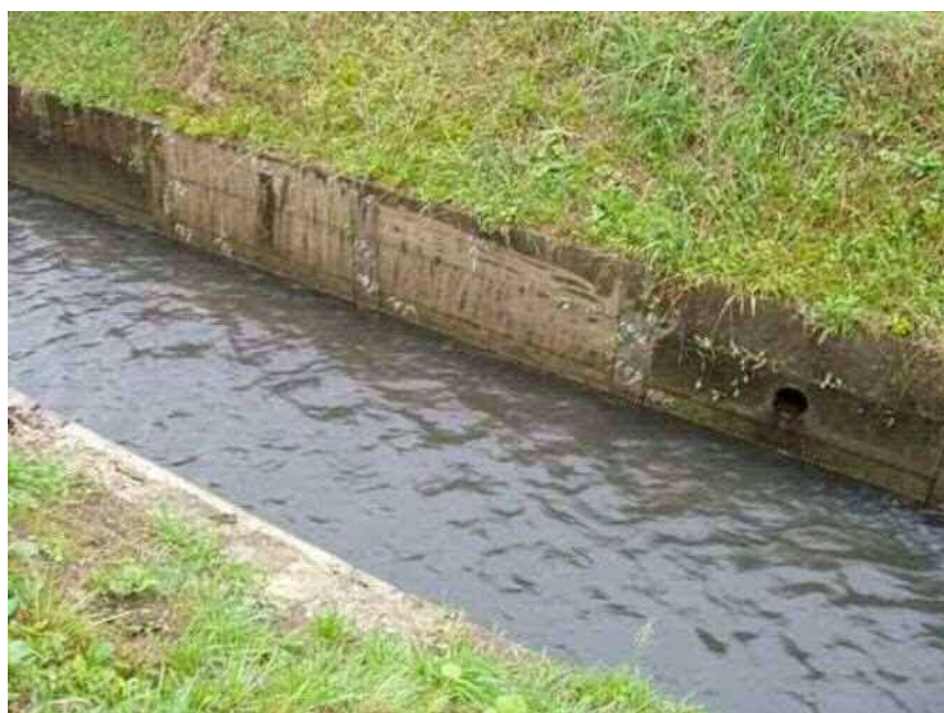
Fig. 3-14 補修前の水路の状況
