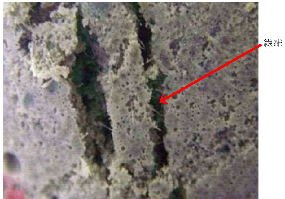
Fig. 6-19 供試体破壊時のひび割れ部分
