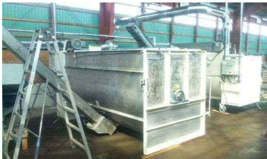
Fig. 2-8 ペーパーズラッジの腐敗対策状況
