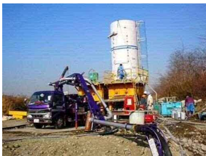
Fig. 3-19 PS 気泡モルタルの製造プラント
