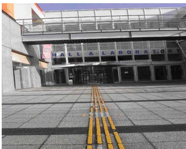
写真(1) -3 剥離した視覚障害者用誘導ブロック
