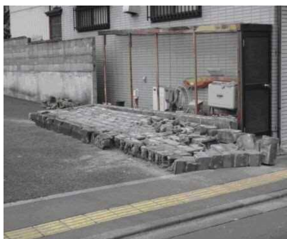
写真(4)-14 東日本大震災当日の倒壊ブロック壁
