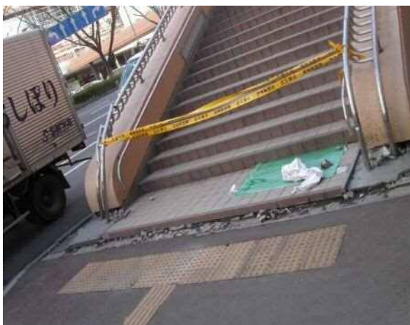
写真(3) -30 ペDESTリアンデッキの段差
