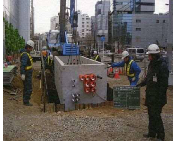
写真(3) - 33 電線共同溝施設
