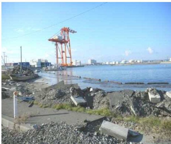
写真Ⅳ－11 震災で生じた地盤変動
