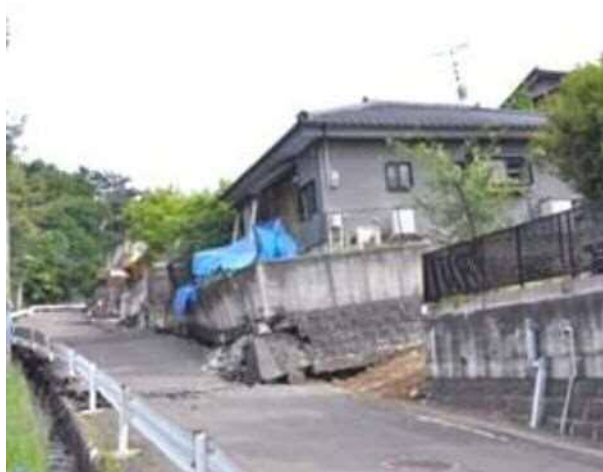
写真V-4 丘陵地に多発した地盤被害
