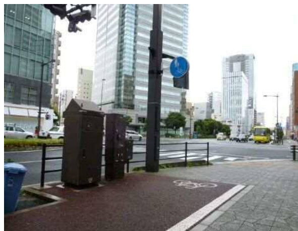
写真(3) -31 国道45号の信号発電設備
